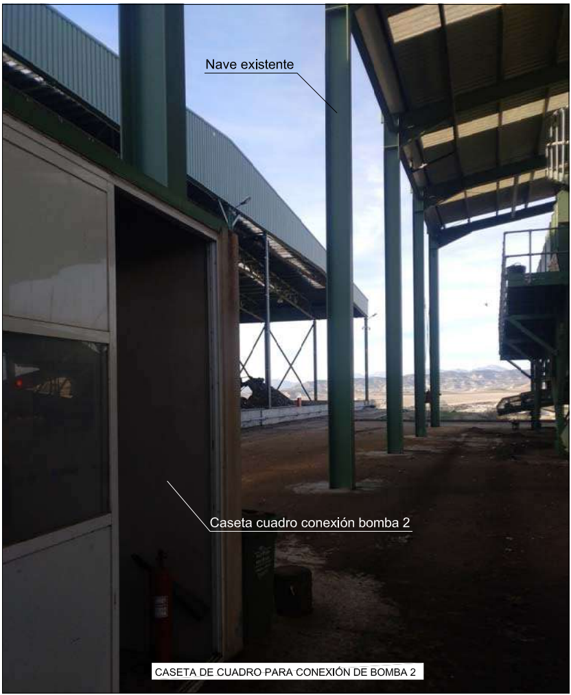
CASETA DE CUADRO PARA CONEXIÓN DE BOMBA 2
