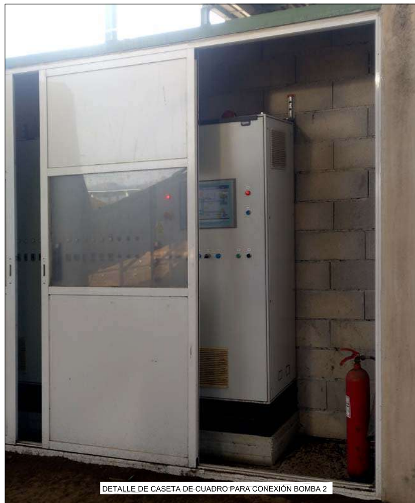
DETALLE DE CASETA DE CUADRO PARA CONEXIÓN BOMBA 2
