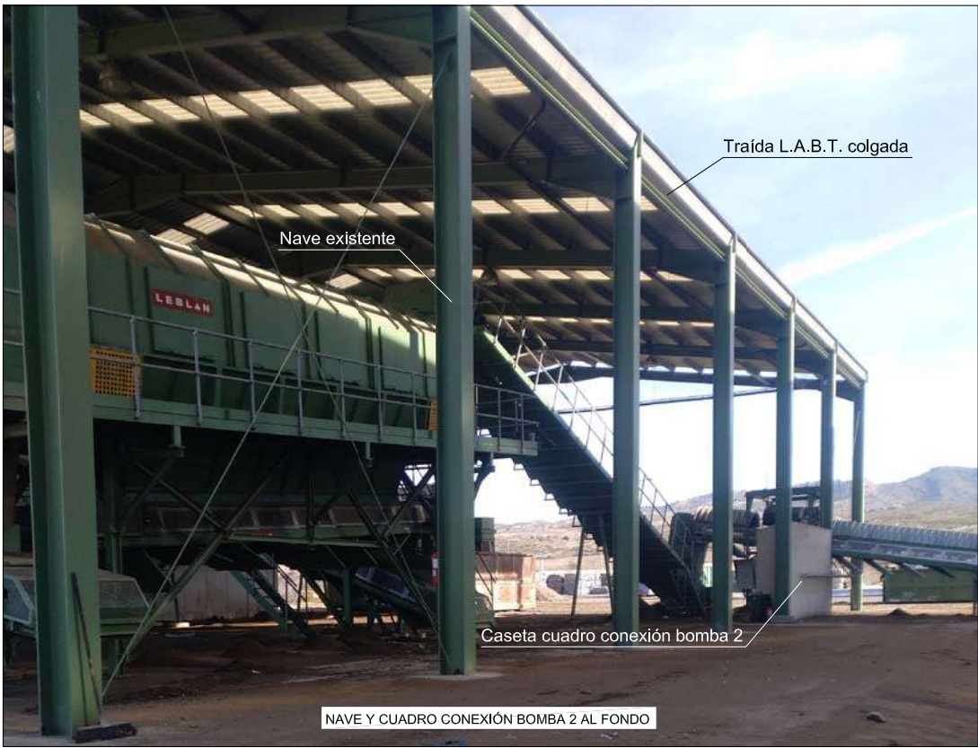
NAVE Y CUADRO CONEXIÓN BOMBA 2 AL FONDO
